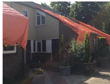
Stormschade na de hagelstorm 23 juni.
